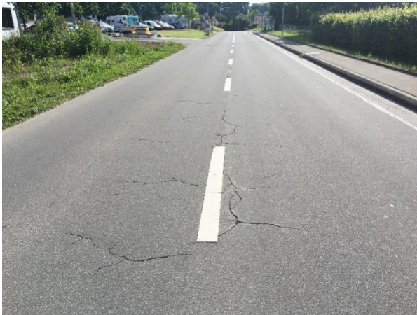
Figure 6 : Tronçon Est – fissuration – Source : Infralab
