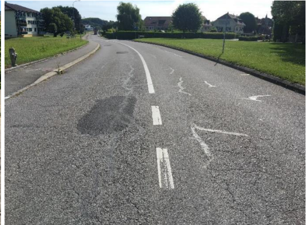
Figure 5 : Tronçon Ouest - faïencage – Source : Infralab
