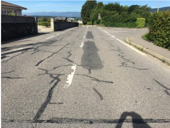
Figure 4 : Tronçon Ouest – fissuration – Source : Infralab
