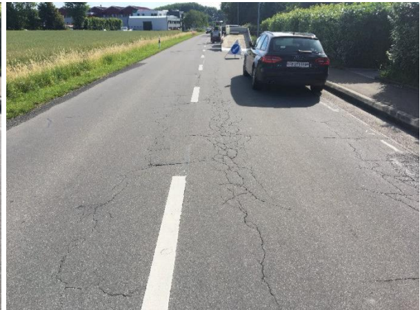
Figure 7 : Tronçon Est - faïencage – Source : Infralab
