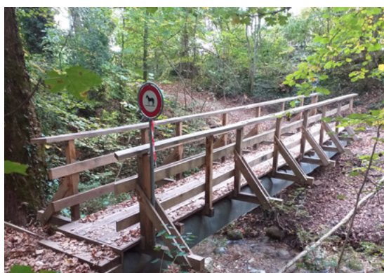
La Passerelle pédestre de l'Oujon à Genolier a bénéficié d'un soutien via le Fonds régional d'aide au tourisme.
