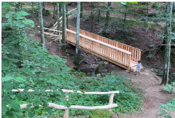
Remplacement de la passerelle du Signal à Longirod, ayant bénéficié d'un soutien dans le cadre du programme Tourisme de nature.
